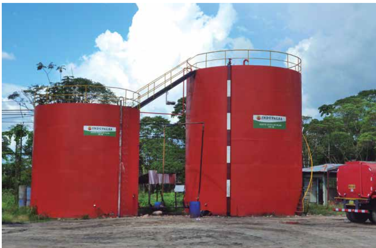
TANQUE DE ALMACENAMIENTO de ACP de la empresa INDUPALSA localizado en el distrito de Caynarachi, San Martín
